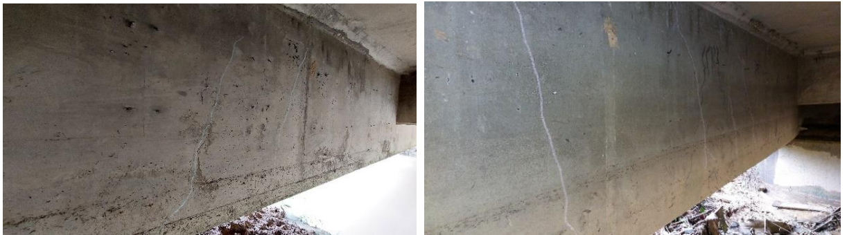
Gambar 1. 1 Retak Geser pada Balok Jembatan
